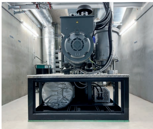
In drei Holzvergasern findet ein thermochemischer Umwandlungsprozess (Pyrolyse) statt, sodass Holzgas entsteht. Durch den Motor im Blockheizkraftwerk (Bild) wird das Gas in Wärme und Strom umgewandelt und diese in das öffentliche Netz eingespeist.
