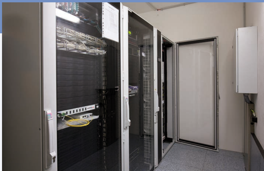
Das neue Rechenzentrum des Gummiwerks KRAIBURG wurde im Sommer 2015 von Rittal ausgestattet.
