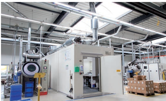
Anmisch- und Umfüllstation mit Absauganlage im Produktionsumfeld
