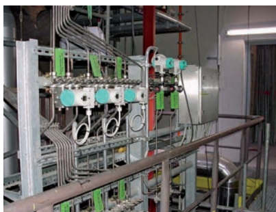
Geräterack und Schaltschrank
