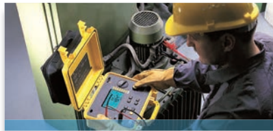
Messung & Prüfung der elektrischen Sicherheit
