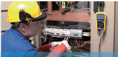
Messung bei Niederspannung
