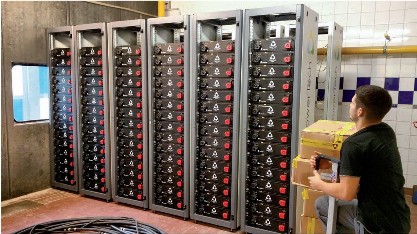
Forscher des Fraunhofer ISE haben auf der Nordseeinsel Borkum einen hybriden Energiespeicher aufgebaut, der aus einer Lithium-Ionen-Batterie und einem Superkondensator für kurzzeitige Leistungsanforderungen besteht.
