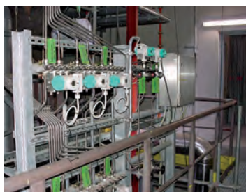
Geräterack und Schaltschrank
