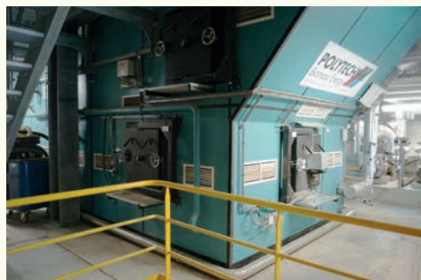
Die Feuerungsanlage hat eine thermische Leistung von 5.500 kW.
