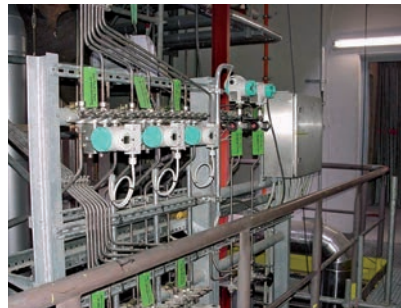
Geräterack und Schaltschrank
