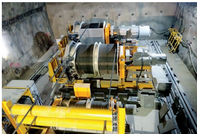
Förderanlage für Tunnelbau mit Antriebsleistung 2.000 kW: Skipwinde, Förderwinde, Personenwinde
