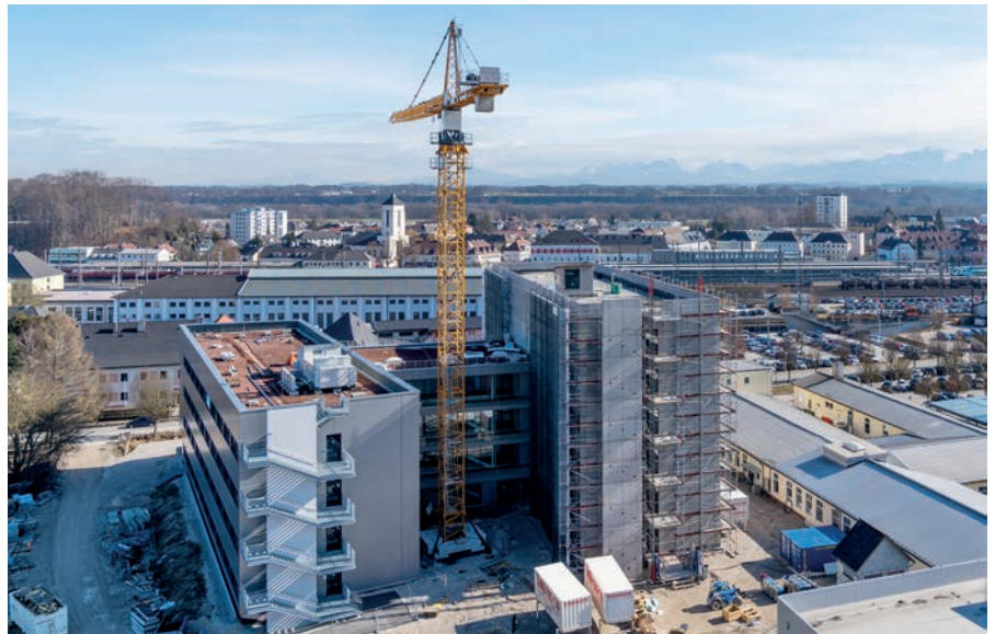
Die Erweiterung des Bürogebäudes schreitet voran. Im ersten Quartal 2020 soll es bezugsfertig sein.
