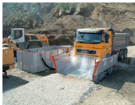
Jetwash, LKW-Reifenwaschanlage „mobil“
