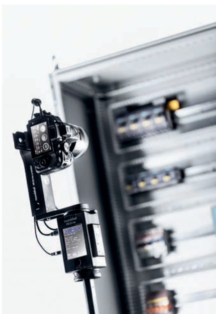
Vermaßung der erforderlichen Kabellängen durch Import hochauflösender Bilder des Schaltschranks.
