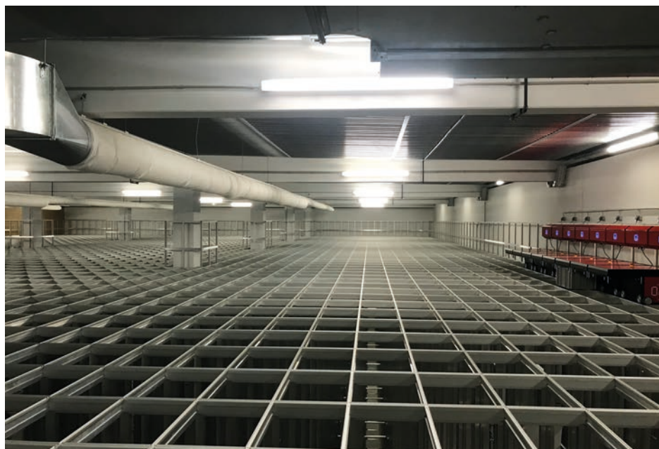
33.000 Boxen mit Elektronikartikeln im automatisierten Hochregallager sind sicher geschützt.
