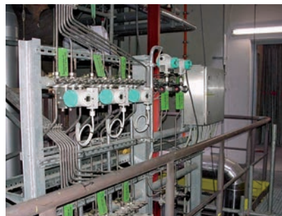
Geräterack und Schaltschrank
