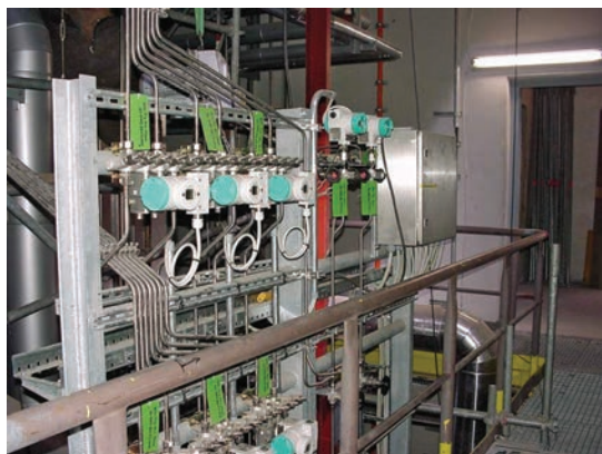
Geräterack und Schaltschrank
