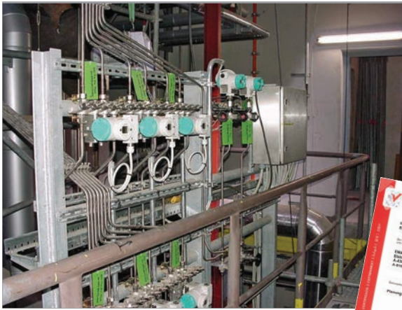
Geräterack und Schaltschrank
