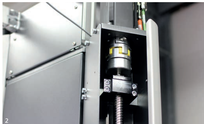
Die horizontalen Holme des lifters werden mittels Kugelspindel-antrieb von TAT bewegt.
