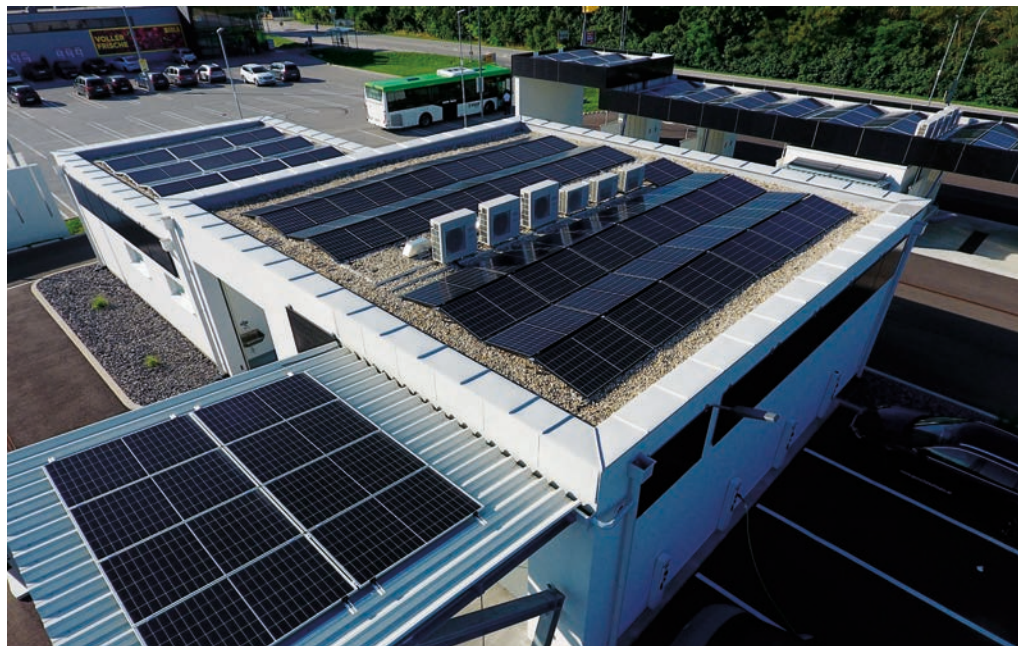
Die Energieversorgung des Autowaschparks in Ebergassing erfolgt primär über eine Photovoltaik-anlage. Die Energie wird lokal gespeichert und mittels smarten Energiemanagements effizient verteilt.
