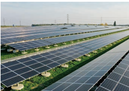
Die PV-Anlage bei der OMV in Schönkirchen spart jährlich 10.000 Tonnen CO 2 .
