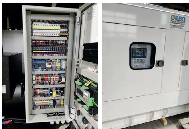
Dank des Connectivity Consulting von Weidmüller konnten 60 Prozent Platz im Schaltschrank eingespart werden.
