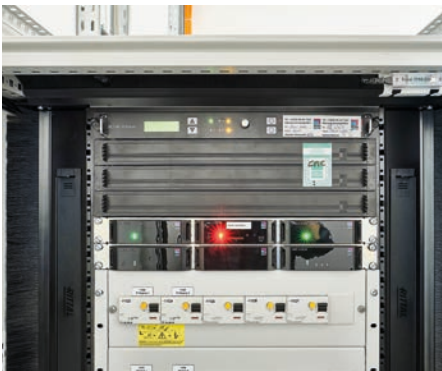
Zur Überwachung der verschiedenen Sensoren in den Racks kommt das CMC III zum Einsatz.
