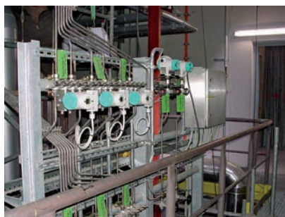
Geräterack und Schaltschrank
