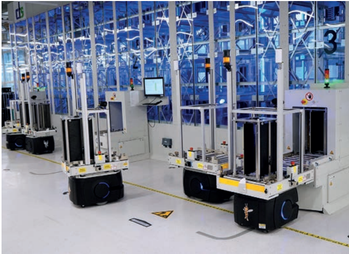
Smart Warehouse für das Leiterplattenmagazin einer Elektronikfertigung – vollständig autonom bedient durch mobile Roboter (AMRs)
