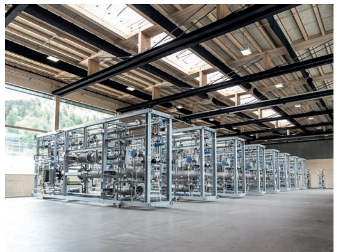
Die Montagehalle der Firma Wagner mit vorgefertigtem Modul aus Edelstahlverrohrungen
