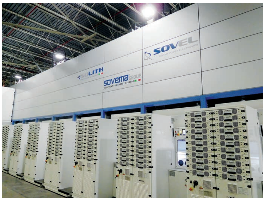
Sovema ist einer der führenden international tätigen Anbieter von Anlagen zur Fertigung hochwertiger Batteriezellen.
