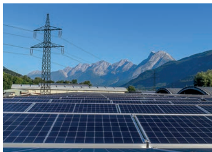
Die neue Photovoltaikanlage am Firmensitz Inzing sorgt für Energiesicherheit und Effizienz.
