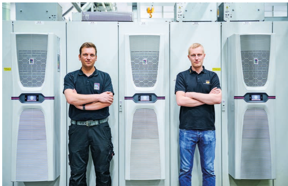
Nur 22 Tage hat die Umrüstung der 138 Kühlgeräte gedauert. Eine Teamleistung von Rittal und Viega: Jan Reifschläger (links), Rittal Service, und Thomas Schild, Viega.
