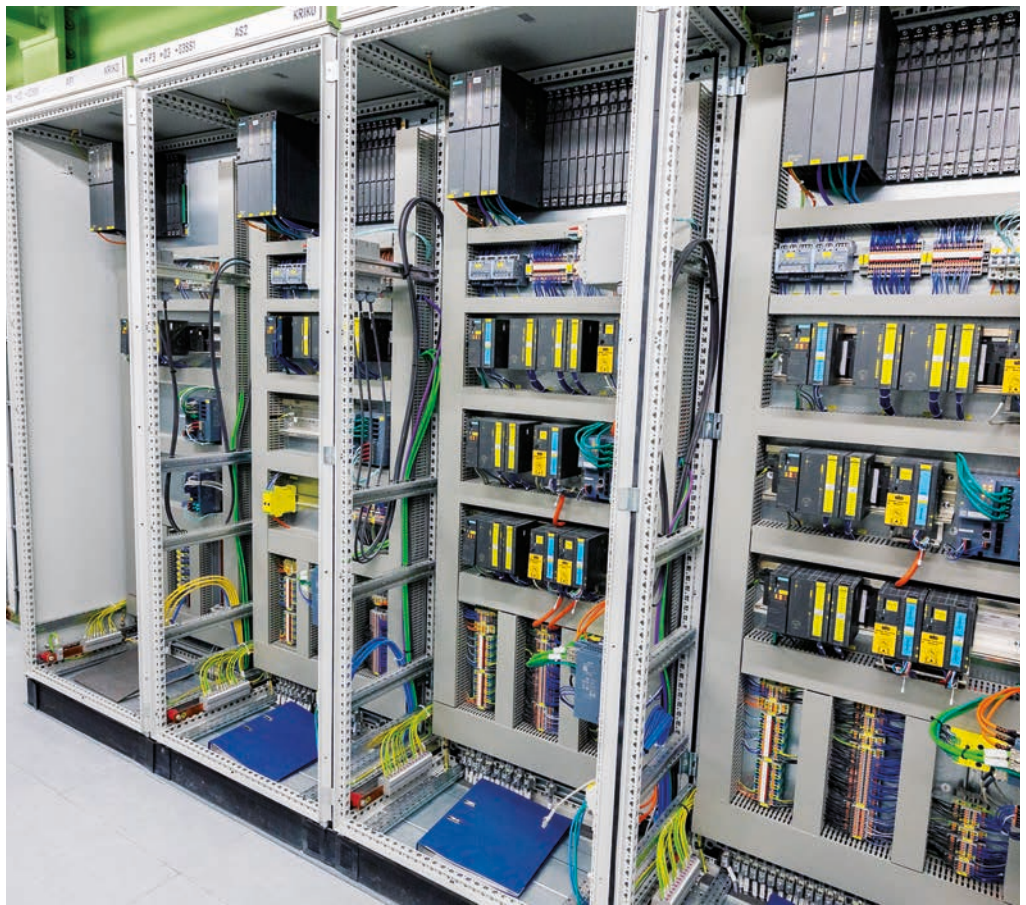
Ein Schaltschrank der Anlage, die jetzt lückenlos in Eplan erfasst ist. Vorteil des Dreigestirns aus Eplan Preplanning, Electric P8 und Fluid: Sto kann jetzt auch alle Pläne und Änderungen selbst durchführen.
