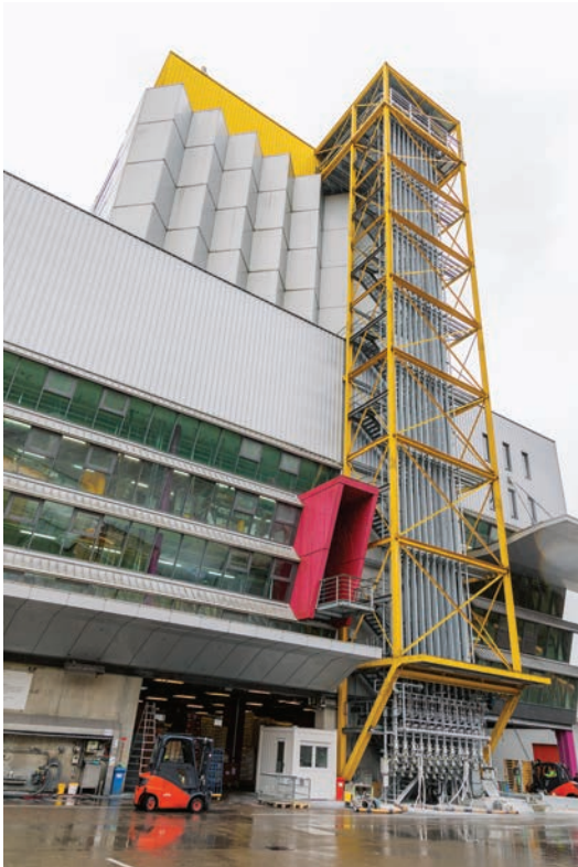
Für die jüngsten Umbauten an der Leistungsanlage in Stühlingen entschied man sich für integriertes digitales Engineering von R&I, Fluidplanung und Elektrotechnik.
