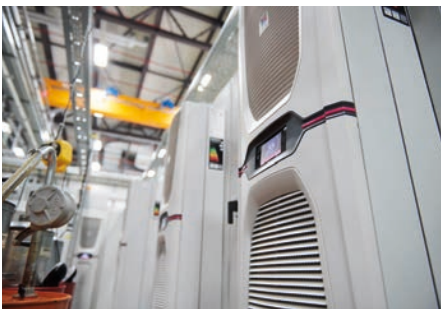
Viega setzt bei der Schaltschrank-Klimatisierung bei allen Maschinen auf Blue-e+-Kühlgeräte von Rittal.
