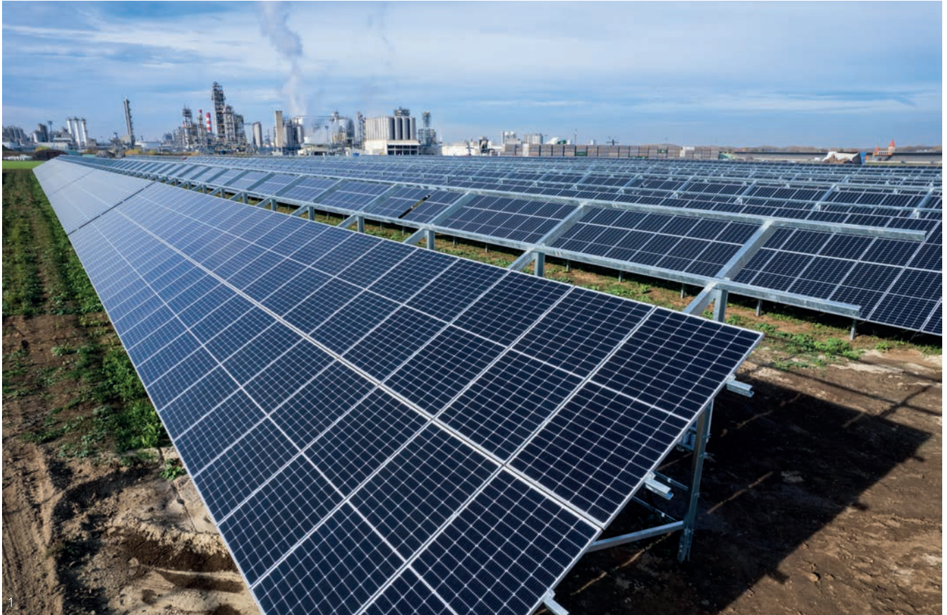
Die neue Anlage in Schwechat ist Borealis' zweite gemeinsam mit VERBUND errichtete Solaranlage, nach Linz, ebenfalls in Österreich.
