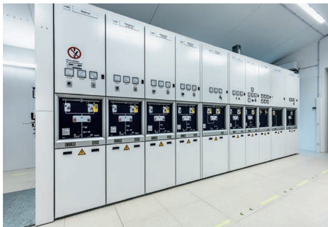
Das Engineering der Schaltschränke und -tafeln erfolgt auf EPLAN Electric P8.
