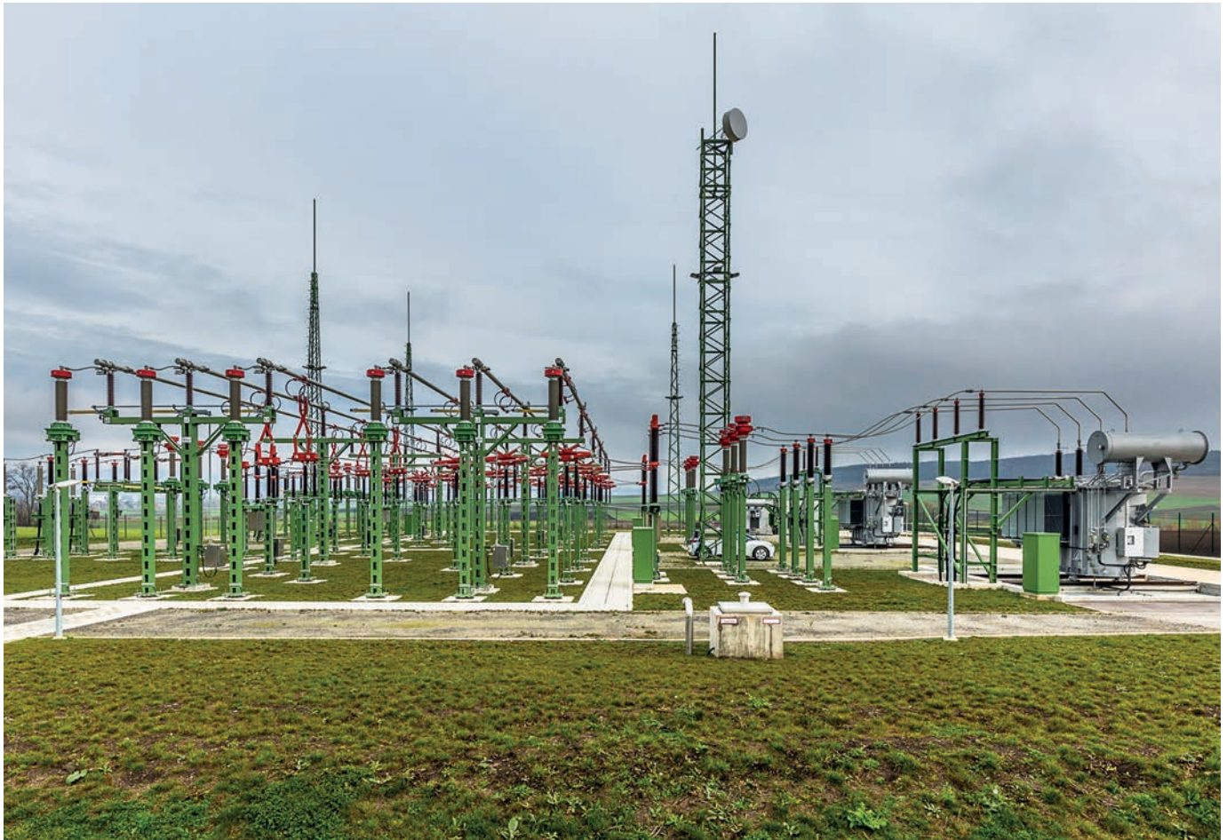
Die Netz Burgenland GmbH betreibt im gesamten Bundesland 21 Umspannwerke.
