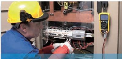
Messung bei Niederspannung
