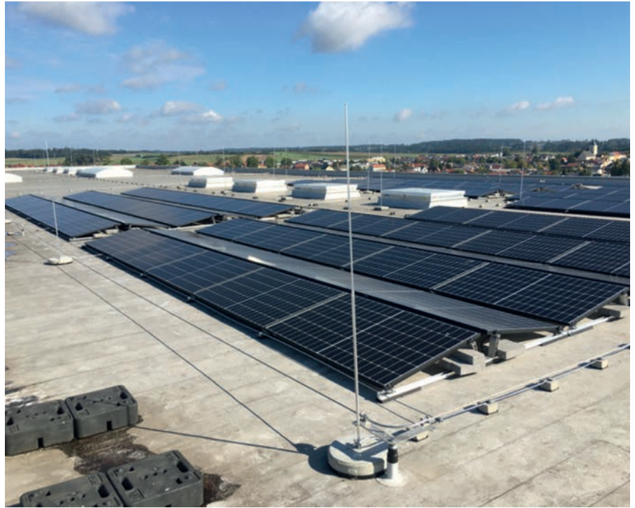
Erster Teil der PV-Anlage am Dach des Vitiser Pollmann-Standortes
