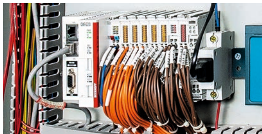
Embedded-PC CX9020 von Beckhoff im gebäudetechnischen Schaltschrank
