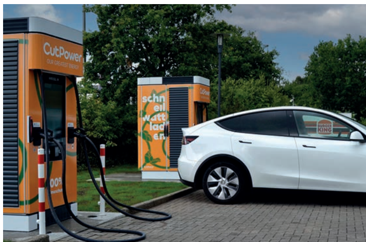
Chimero als CutPower-Tower bei Burger King in Flensburg
