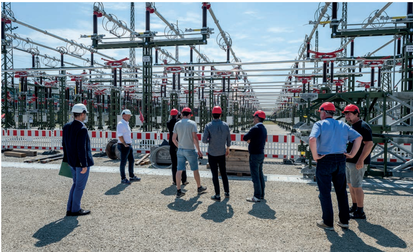
APG investiert 150 Millionen Euro in die Modernisierung des Umspannwerks Ernthofen.
