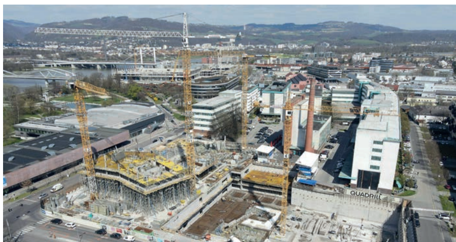
Die Hochbauarbeiten gehen zügig voran. Bis Ende dieses Jahres soll bereits eine Turmhöhe von 60 Metern erreicht sein.
