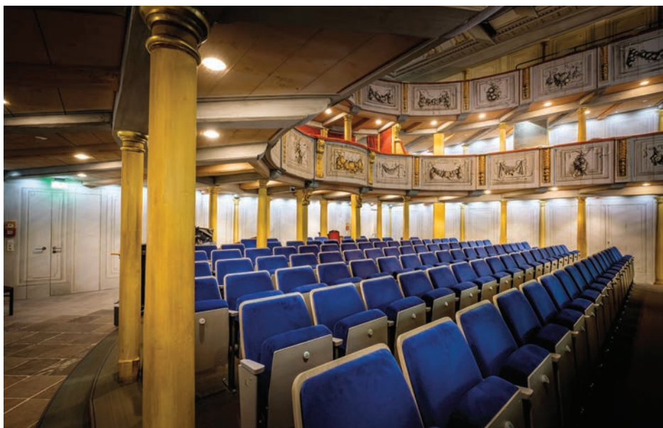
Im historischen Schlosstheater Celle sind die Ansaugöffnungen der TITANUS® Rauchmeldeanlage unauffällig in die historische Architektur integriert.
