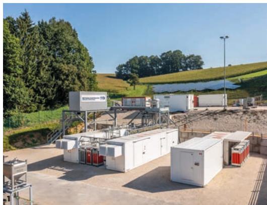
Die Methan-Elektrolyse-Anlage im RAG Energy Valley in der Krift bei Kremsmünster
