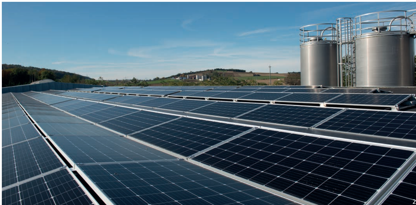
Ein Solarkraftwerk am Dach der MIRAPLAST-Zentrale in Würmla erzeugt ca. 30 Prozent des jährlichen Stromverbrauches.
