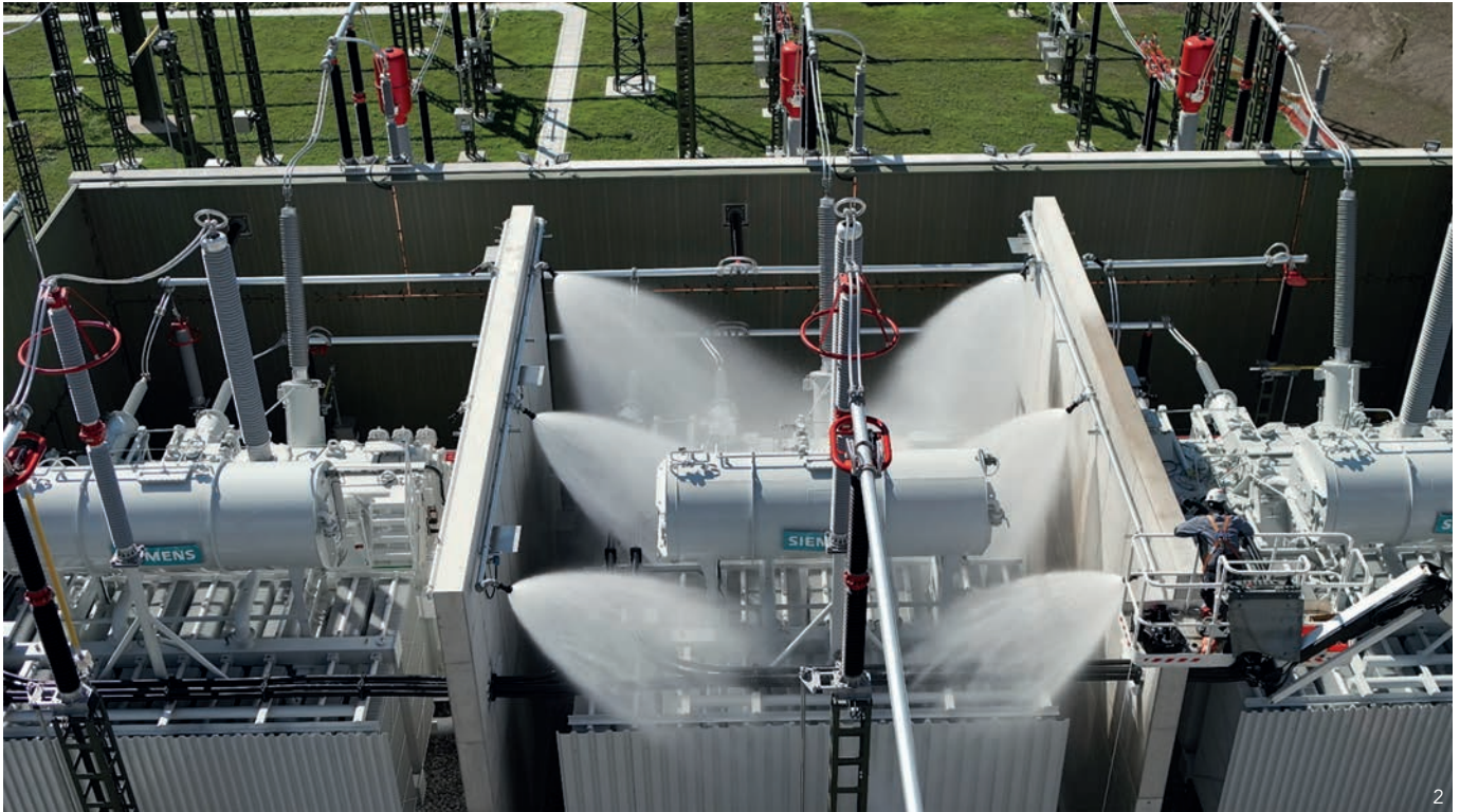
Hocheffiziente Sprühwasserlöschanlagen mit Hohlstrahldüsen und Infrarot-Detektion sorgen für den korrekten Brandschutz für die Transformatoren in den Umspannwerken.
