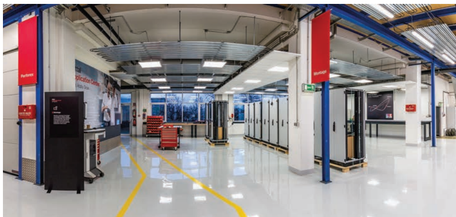
Im Rittal Application Center dreht sich unter dem Motto „Join. Apply. Grow.“ alles um praktische Anwendungen im Steuerungs- und Schaltanlagenbau sowie die Optimierung der Wertschöpfungsketten.
