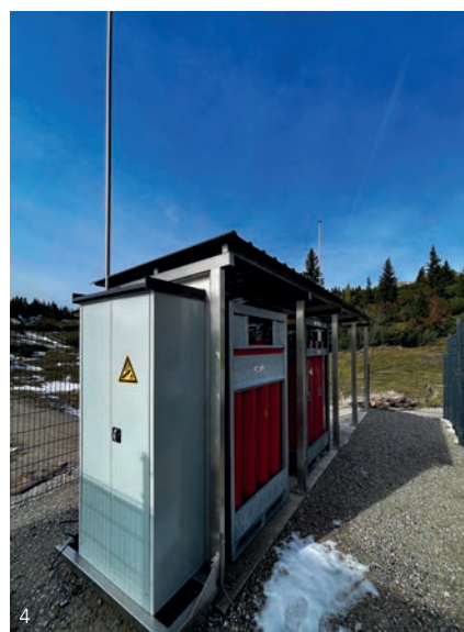
Die Wasserstoffanlage auf der Sonnschienhütte ist im gesamten DACH-Raum die erste Wasserstoffanlage in einer Alpenvereins-hütte.
