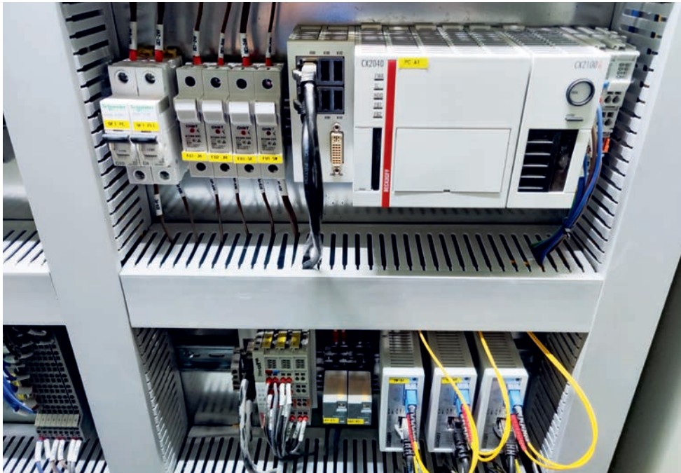
Ein Embedded-PC CX2040 mit einem Quadcore-Prozessor Intel Core i7 bietet eine hohe Rechenleistung zur Steuerung der vielen Servoachsen in der Installation.
