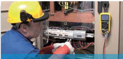
Messung bei Niederspannung
