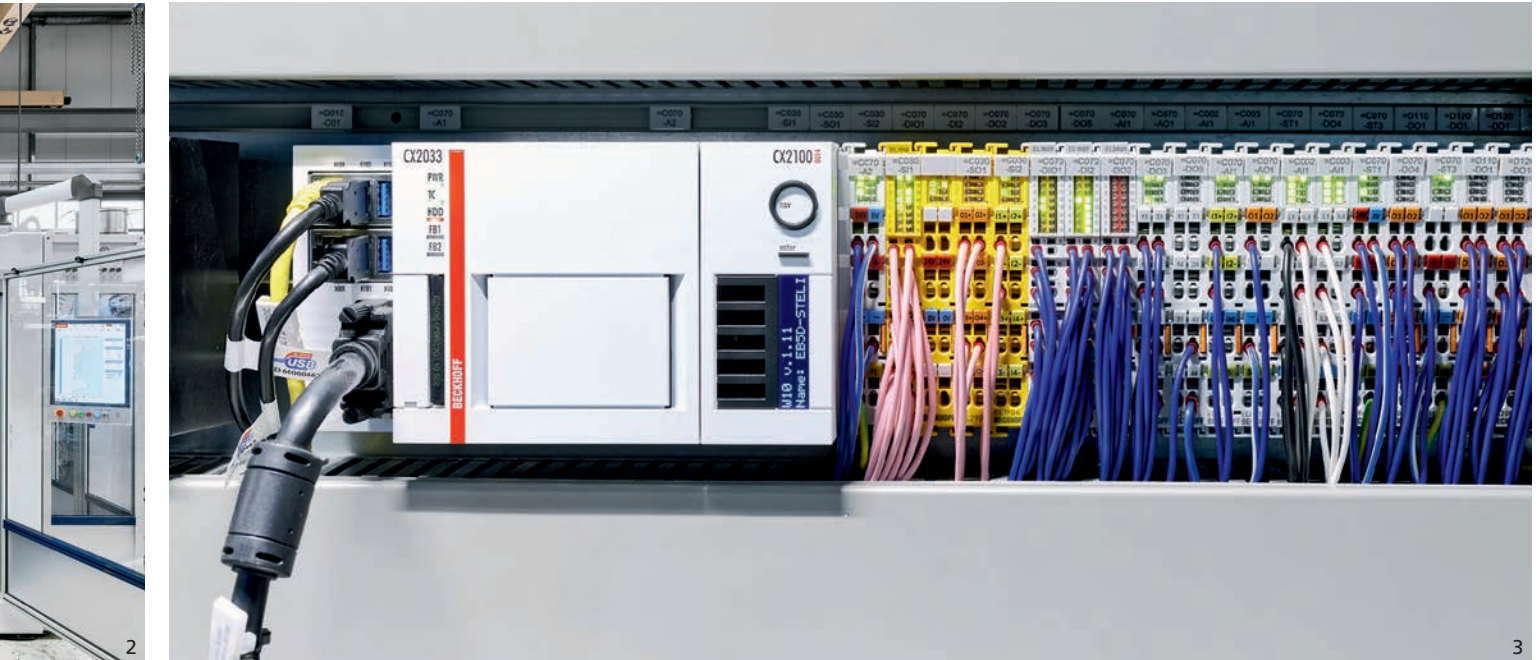
Die vollelektrischen Blasformmaschinen mit Doppelstation steigern mit PC-based Control die Produktionsleistung bei geringerem Material- und Energieverbrauch (2). Sämtliche Fahrprofile und Temperaturregelstrecken der Blasformanlage werden mit einem performanten Embedded-PC CX2033 automatisiert (3).
