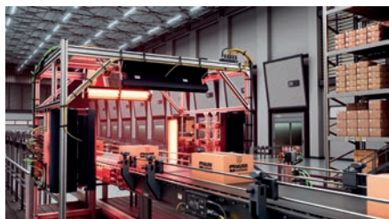
Der Hybrid Managed Switch ermöglicht die Installation von bis zu vier Kameras pro Switch, direkt am Scantunnel.
