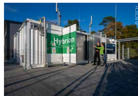
Zwei Hybrion PEM-Elektrolyse-Stacks von Bosch sind in den Elektrolyseur integriert.
