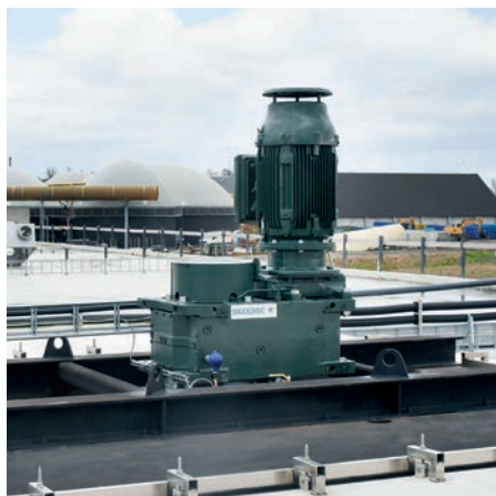
16 MAXXDRIVE-Industriegetriebe stellen die Biogaserzeugung in der Anlage der Smits Groep sicher.
