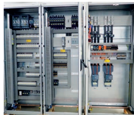
Komplexe Schaltschranklösung für industrielle Anwendungen.
