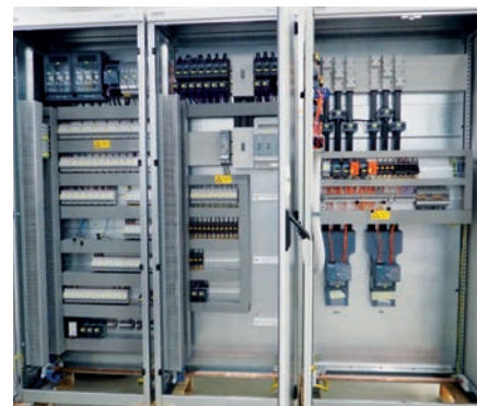
Komplexe Schaltschranklösung für industrielle Anwendungen.
