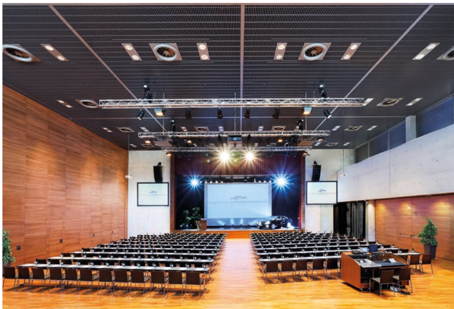
Die durchgängige Beckhoff Technik vereint alle im Gebäude befindlichen Anlagen und Systeme in einer einfachen, benutzerfreundlichen Oberfläche.
