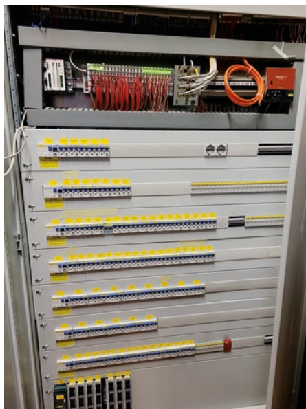
Einer der Schaltschränke im FPCC mit einem Ethernet-TCP/IP-Buskoppler BK9050, zahlreichen angereicherten Busklemmen und einem 16-Port-Ethernet-Switch CU2016
