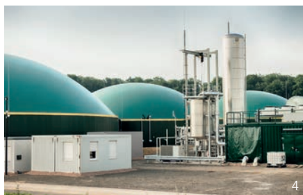
Ein Luftpolster hält das Kuppeldach der Speicherzylinder immer straff gespannt, auch bei wechselndem Gasdruck im Inneren.
