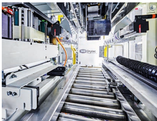
Die Anlage führt verschiedene Prozessschritte vollautomatisch durch.
