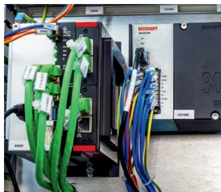
Die hohen Anforderungen an die synchrone und dynamische Ansteuerung der 32 Mover realisiert Cleverttech mit TwinCAT 3 auf einem Ultra-Kompakt-Industrie-PC C6032.
