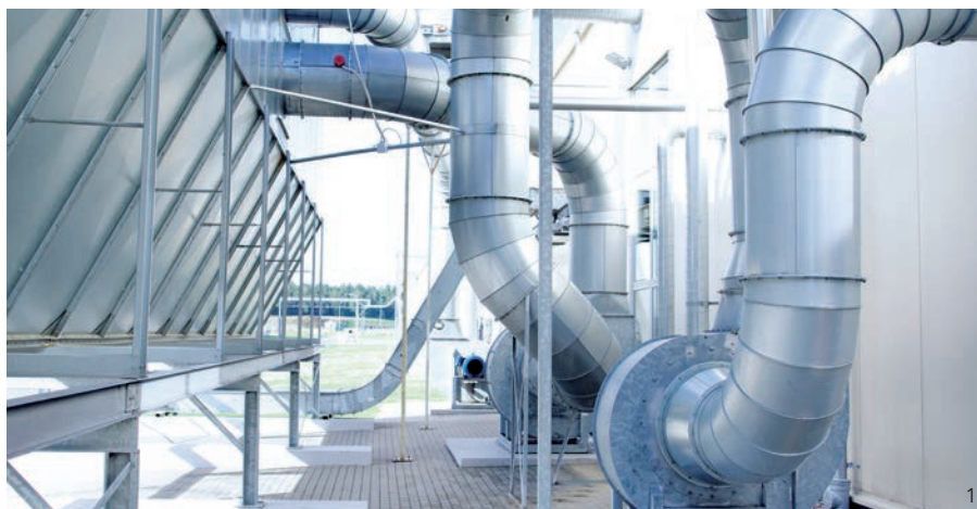
Lufttechnik ermöglicht nachhaltige Prozesse in der Umwelt- und Energiebranche.
